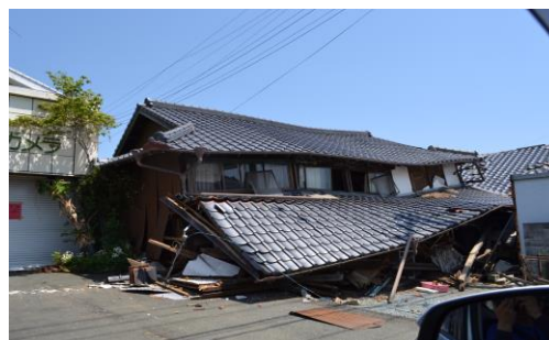
益城町ではいたるところで家が崩壊していた
